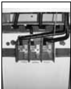
Utility Lug Landing
